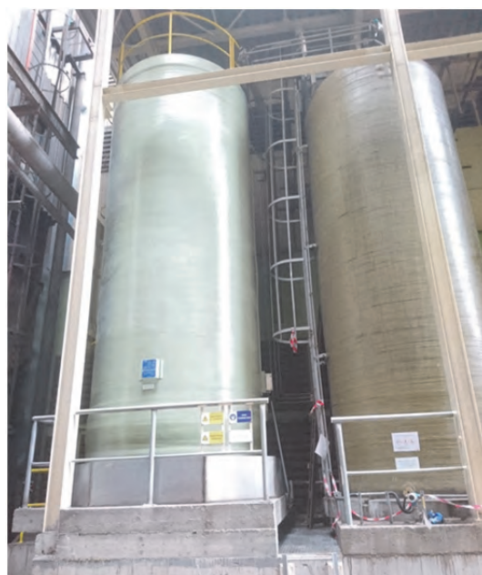
Obr. 5 Provozní nádrže reagentu
