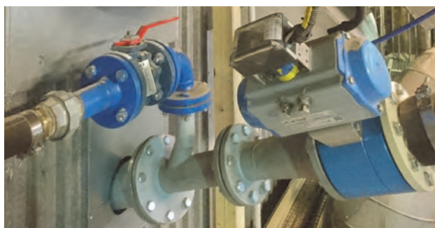
Obr. 2 Zaústění tras pneudopravy vápence do spalovací komory
