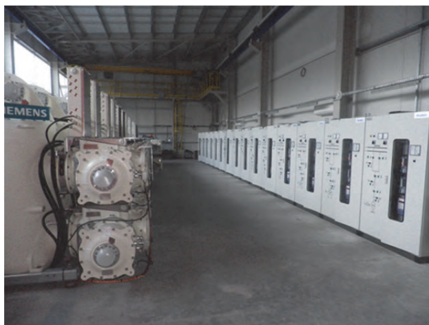
Energetika Třinec – nová GIS rozvodna 2
