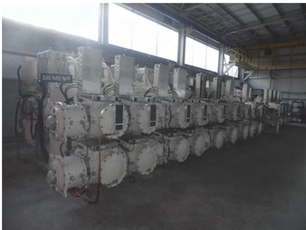
Energetika Třinec nova GIS rozvodna 1
