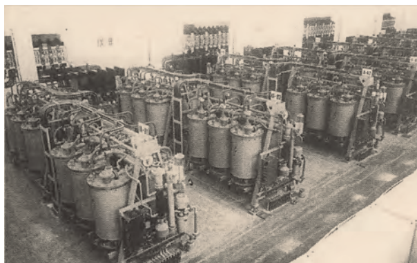
Obr. 1 Pohľad do haly meniarne, v ktorej boli inštalované ortuťové usmerňovače ČKD Praha, Žiar nad Hronom, 1952
