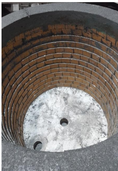
Obr. 1 Vyzdívka licí pánve / Fig. 1 Ladle Furnace Refractory Lining
