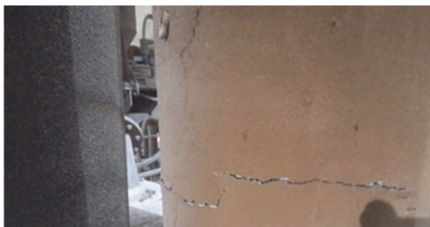
Obr. 8 Vada GE 4A – prasklina vrstvy alitace
