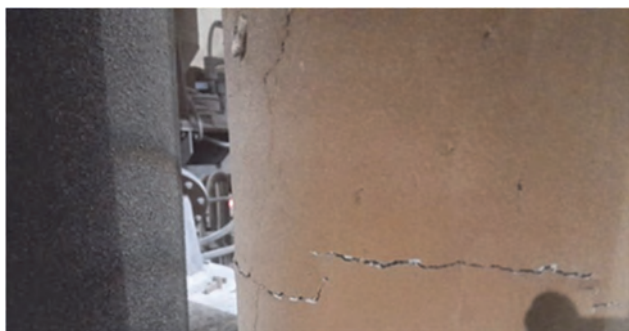
Obr. 8 Vada GE 4A – prasklina vrstvy alitace
