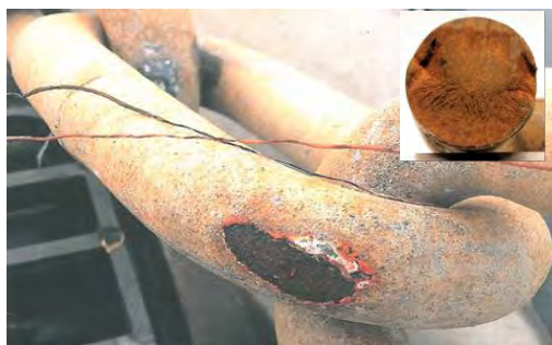
Obr. 2 Korozi napadená vrstva zinkového povlaku na rybářském řetězu a lomová plocha jiného prasklého článku Fig. 2 Layer of zinc coating on fishing chain attacked by corrosion and fracture area of other link of chain
