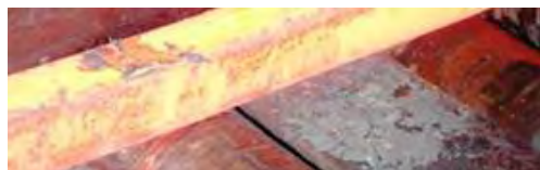
Obr. 2 Neodstraněný nátěr Fig. 2 Non-removed coat
